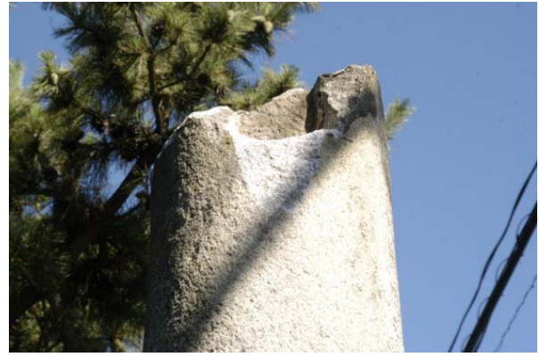
第8図 折れて落下した東側の柱の貫より下の部分. 貫の下には新鮮な剥離痕があるが、南側の破断面は汚れていて、今回までにひびが入っていたことがわかる..
