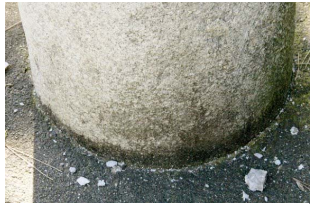
第10図 西側の柱の基部. 北側 1/3 に、斜めにひびが入っている. ひびの縁は新鮮であるが、ひびの隙間の中は汚れていて、以前にできた傷である。
