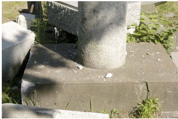
第9図 東側の柱の基部とその周囲の土台には損傷痕は認められないが、南側に古い損傷痕がある. 土台の北西角の傷は新鮮で、今回できたものである。
