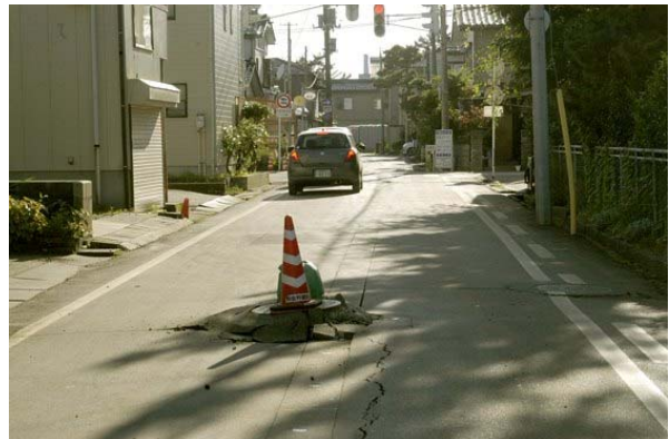
第8図 柏崎市比角1丁目、第二中学校グラウンド南の道路に見られた砂丘上におけるマンホールの浮き上がり。
