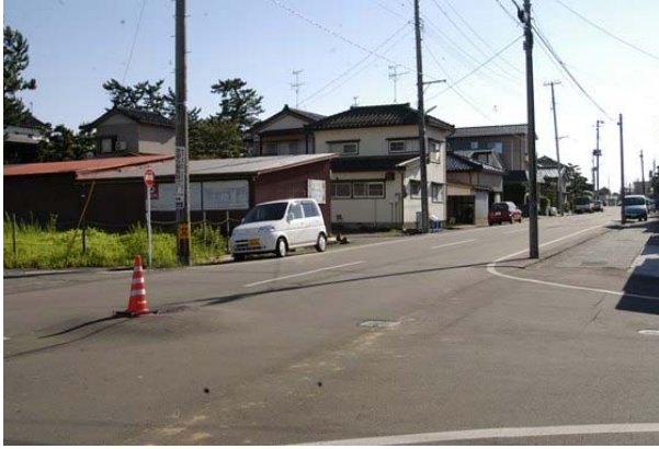
第 9 図 東向き砂丘緩斜面上の、県道 152 号線の一本北側の通りの交差点に見られるマンホールの浮き上がり。
