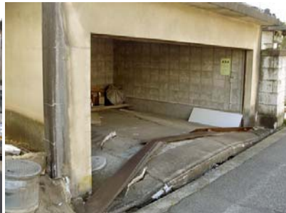
第 12 図 第 11 図の道路の斜面下部での車庫の床の盛り上がり。液状化によって盛り上がったとみられる。
