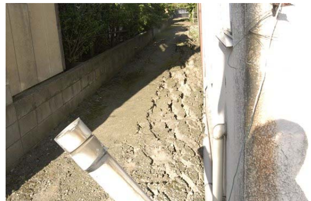
第 15 図 第 14 図の建物の北側の路地では、路地の路面が盛り上がりとともに、建物の沈下が見られる。建物の基礎は、斜面と反対方向に緩く傾斜した。
