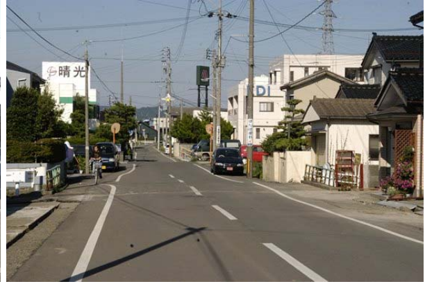
第 10 図 交差点から東側を眺めると、道路のうねりが見られる。側溝には東西方向の衝突痕がみられる。
