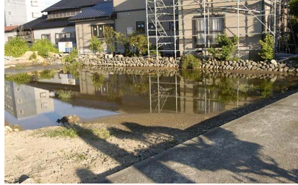
第 17 図 柏崎市北半田の低地側にある溜池 第 16 図の溜池とともに、地震の後で水位が 20cm ほど低下したということであり、底には亀裂がみられた。低地にもかかわらず、地下水位は高くはなかったとみられる。
