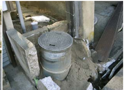
第 13 図 第 12 図の車庫の床の盛り上がりの斜面下隣では、噴砂とマンホールの浮き上がりがみられる。
